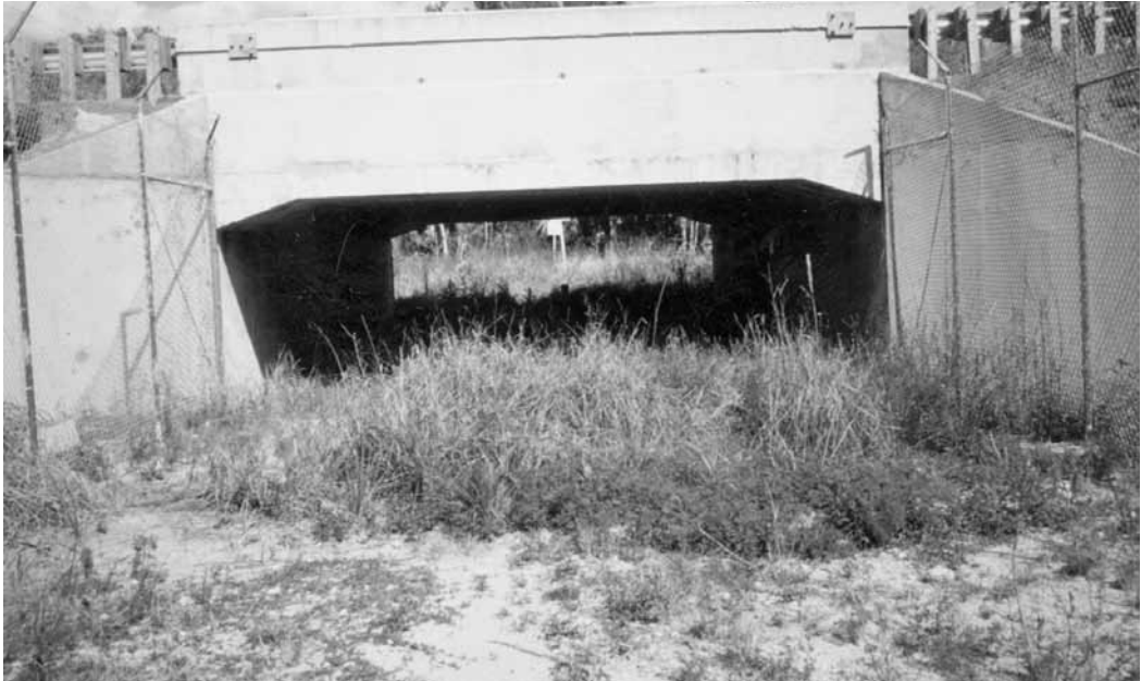
Ryc. 3.7. Przejście dolne o przekroju prostokątnym, używane przez pumy florydzkie ( Puma concolor coryi ), czarne niedźwiedzie ( Ursus americanus ) i wiele innych zwierząt. Prefabrykowana konstrukcja z otworem o wymiarach 8x25 stóp (2,4x8 m) została wstawiona w dwujezdniową autostradę i wyposażona w ogrodzenia naprowadzające. Podczas robienia fotografii, w przejściu znajdowały się ślady pumy i aparat fotograficzny wyzwalany przez czujnik podczerwieni. Droga nr 29, Południowa Floryda. Fotografia: R.T.T. Forman.
